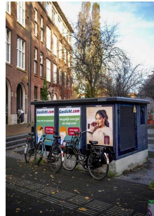
Elektriciteitshuisje op het Timorplein.
